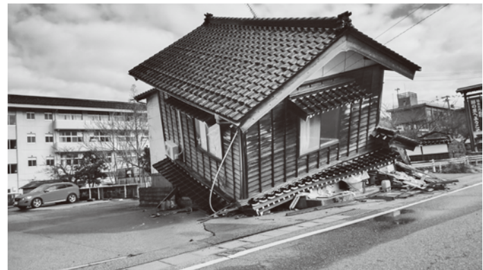
倒壊した家屋(派遣市職員から写真提供)
